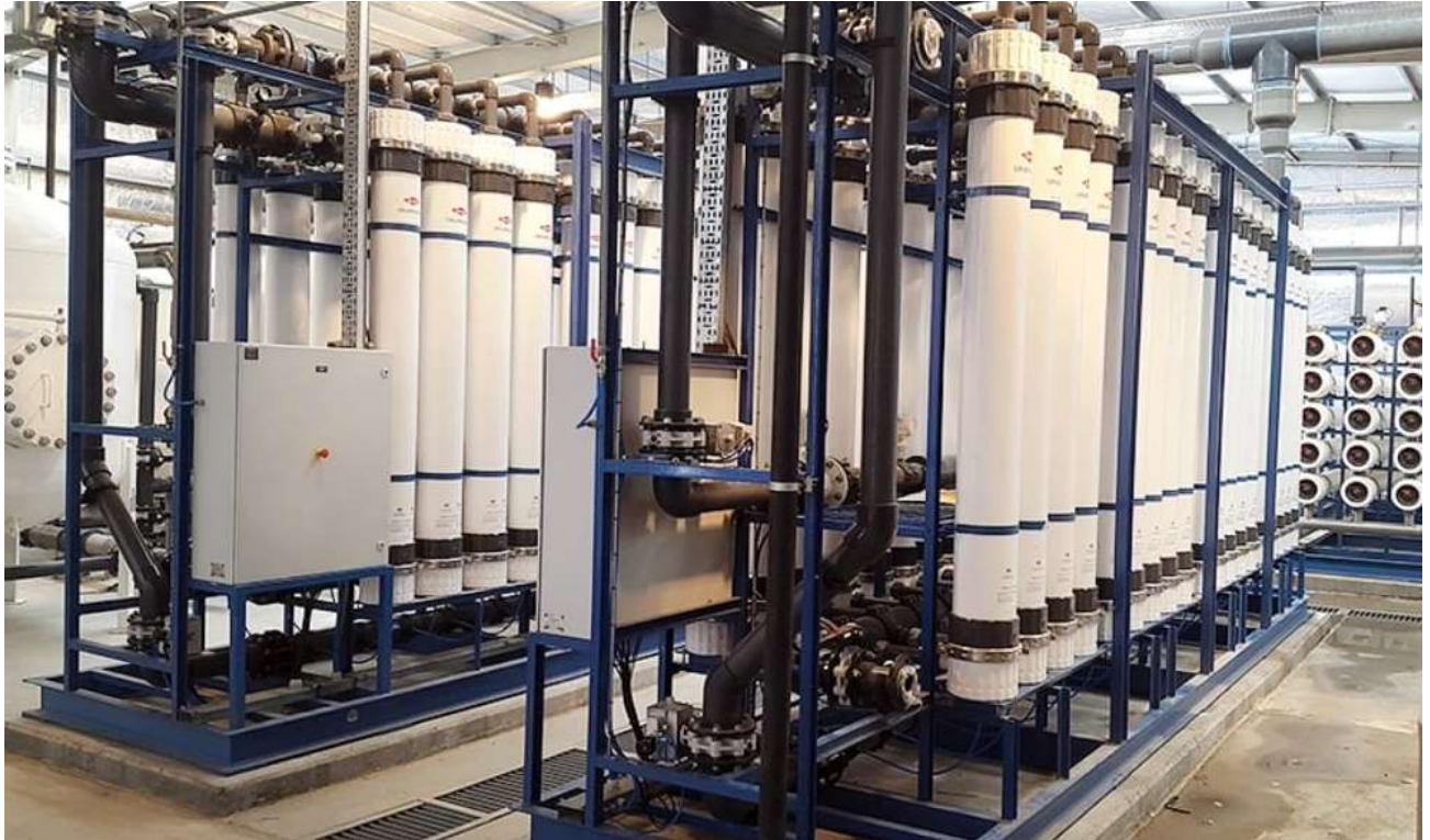
Figura 147 Planta potabilizadora por osmosis inversa de 1MW, 3000 m 3 /d en Puerto Deseado (Fuente J.Orellano – SPSE)
