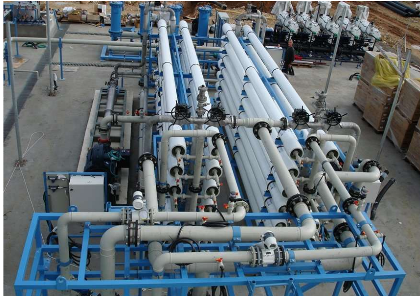
Figura 142 Planta de Tratamiento de agua por osmosis inversa [Filtomat Water Systems]
