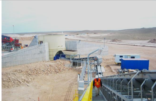
Foto 4.6-4. Vista de la zona de alimentación a molienda. Se observa el domo que cubre el stock de alimentación.
