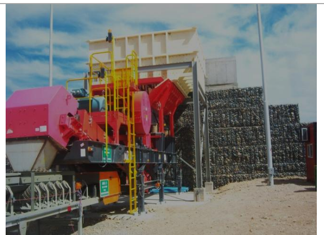
Foto 4.6-3. Vista del circuito de trituración secundaria.
