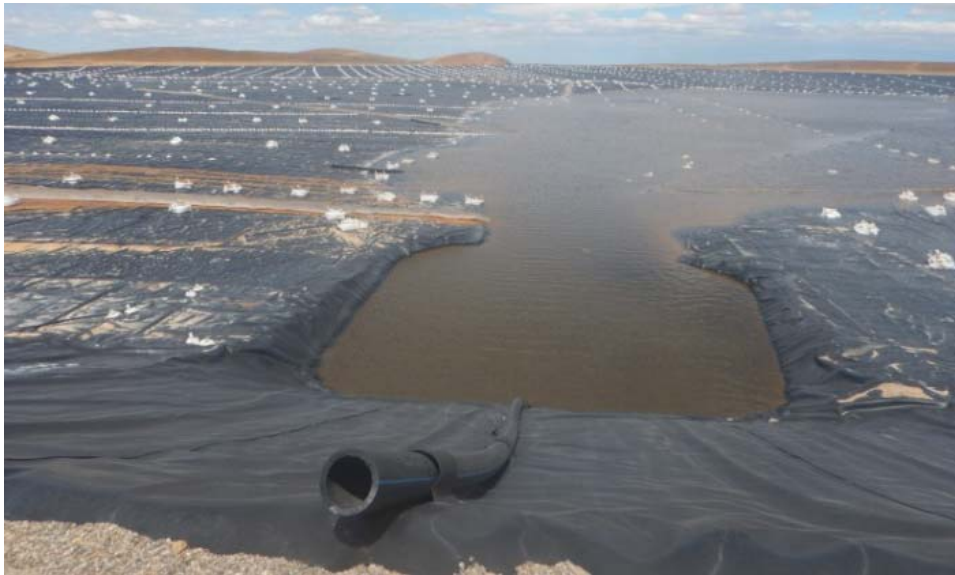
Foto 4.12-12. Sumidero en el Muro 1.
