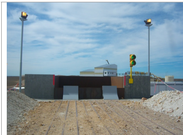
Foto 4.6-2. Vista de la zona de descarga del ROM en la trituradora primaria.
