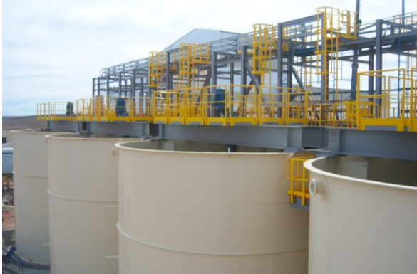
Foto 4.6-6. Vista de los tanques de lixiviación (CIL).
