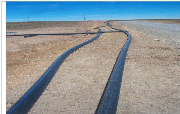
Foto 4.12-7. Vista de las tuberías de relave y agua recuperada desde el sector Este.
