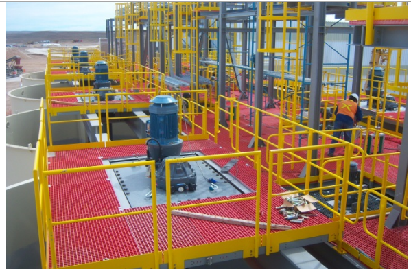
Foto 4.6-7. Vista de la zona de lixiviación. Se observan los motores de los agitadores de los tanques y las plataformas de trabajo sobre los mismos.
