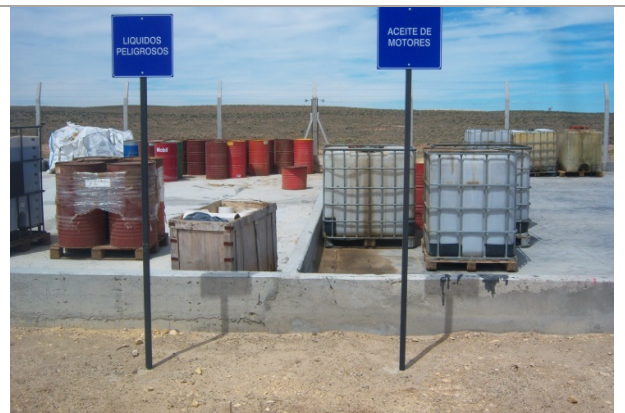
Foto 4.15-15. Estructura de contención en acopio de Aceites usados y líquidos peligrosos. Se observa la clara identificación del contenido de cada sector.
