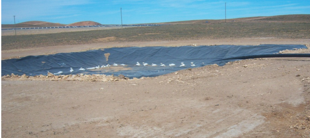
Foto 4.12-6. Pileta de contención de fugas de las cañerías de transporte de relaves y de recuperación de agua.
