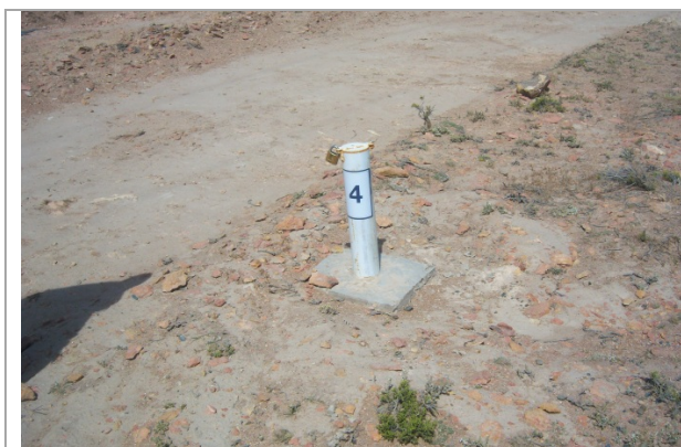
Foto 4.12-14. Pozo de monitoreo.
