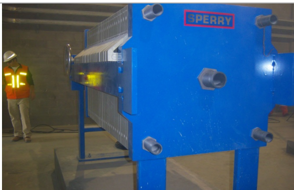
Foto 4.6-10. Filtro prensa que se utilizará para desaguar los lodos antes de la fundición.
