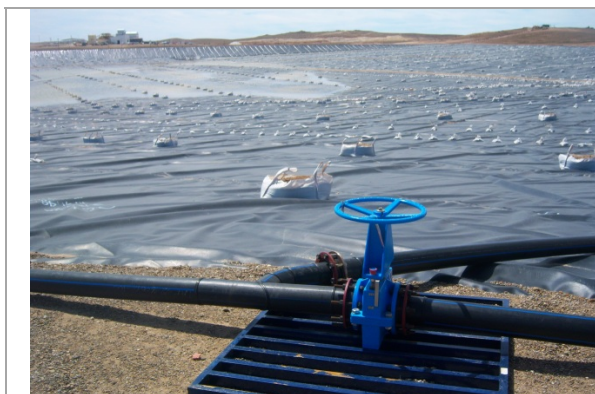
Foto 4.12-9. Punto de división de la tubería de relaves.
