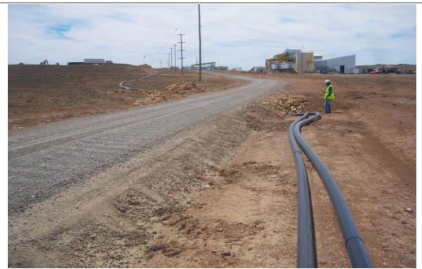
Foto 4.12-8. Vista de las tuberías desde el sector Oeste.
