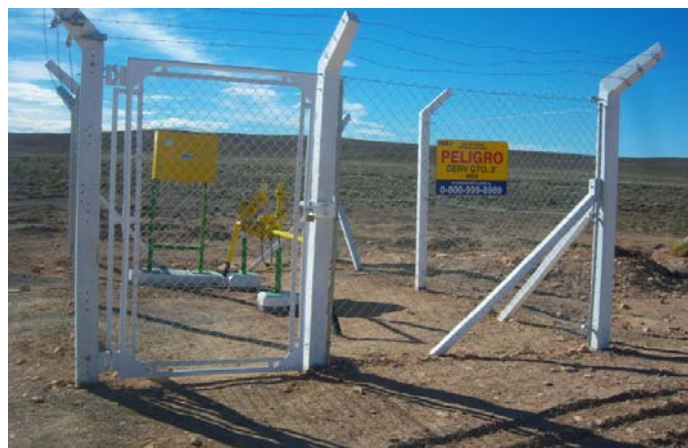
Foto 4.22-1. Cabecera del gasoducto, es la unión con el gasoducto General San Martín.
