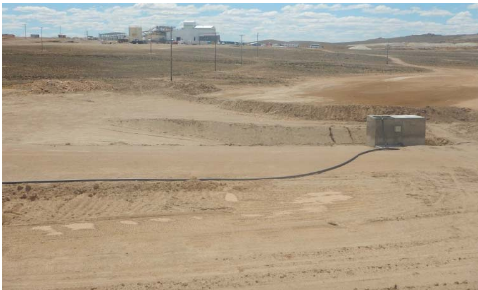
Foto 4.12-13. Sistema de bombeo de Ataguía
