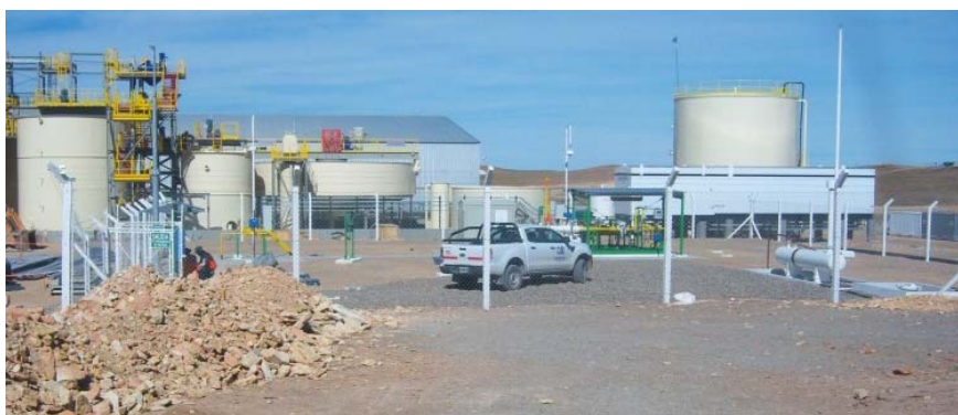
Foto 4.22-3 Planta reductora de presión, en el sector Sur de la planta de Procesos, que puede verse al fondo
