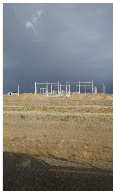
Fotografía 9.1 y 9.2. Vista del Parque Eólico y la estación transformadora
