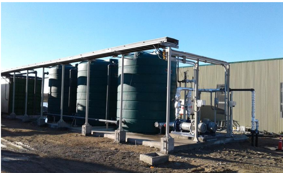
Fotografía 26.8. Planta de osmosis modular instalada Planta 2. Sistema de almacenamiento de agua permeada y bombeo a planta de procesos.
