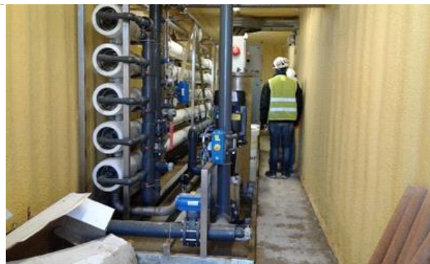
Fotografía 26.7. Planta de osmosis modular instalada Planta 2. Modulo Osmosis (Modular)
