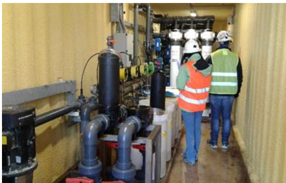
Fotografía 26.6 Planta de osmosis modular instalada Planta 2. Modulo UF (Modular)
