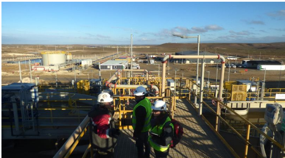
Fotografía 17.9. Área de Detoxificación y espesamiento de colas de procesos
