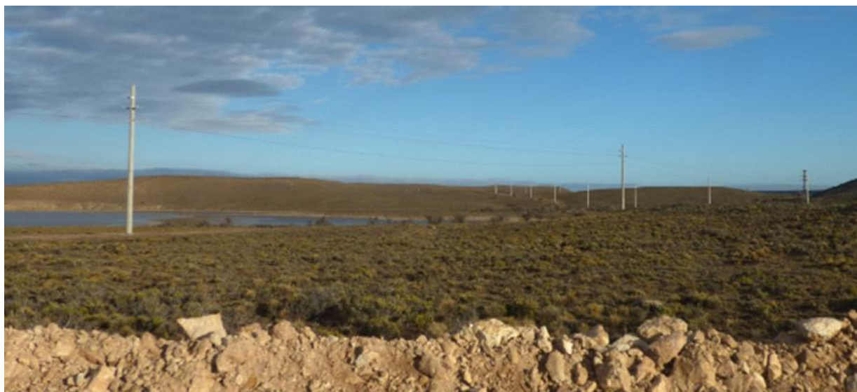
Fotografía 29.1. Red distribución eléctrica en 13,2 Kv
