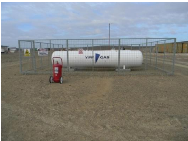
Fotografía 26.3. Instalaciones de GLP
