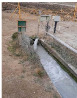
Fotografía 31 Aforo Salida del Sistema Kospi
