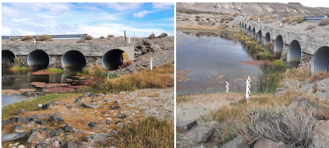
Figura 10.1 Situación actual de buenas condiciones de las regletas de medición.
