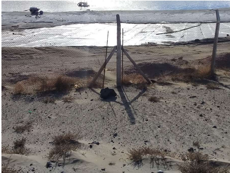
Figura 78: Cerco perimetral con un espacio que permite la entrada de la fauna de las inmediaciones.
