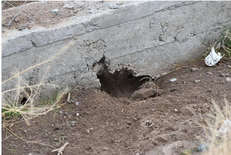
Figura 79: Cueva de Chaetophractus villosus que ha dañado la pared de concreto del cerco perimetral.
