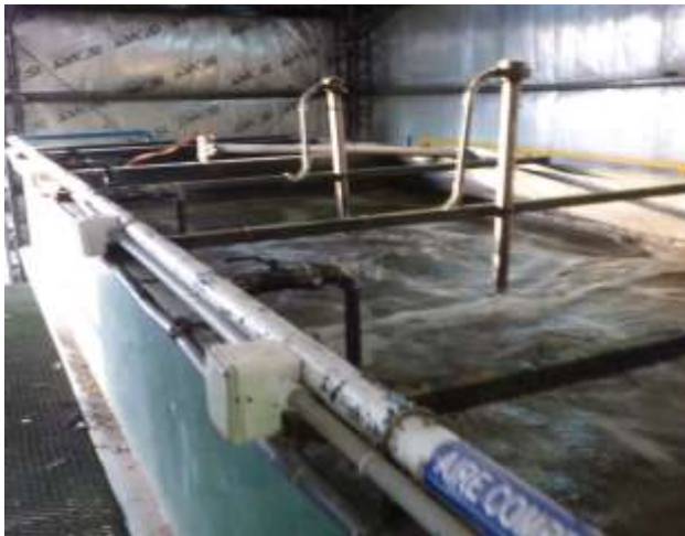
Fotografía 33: Detalle del tratamiento de efluentes
