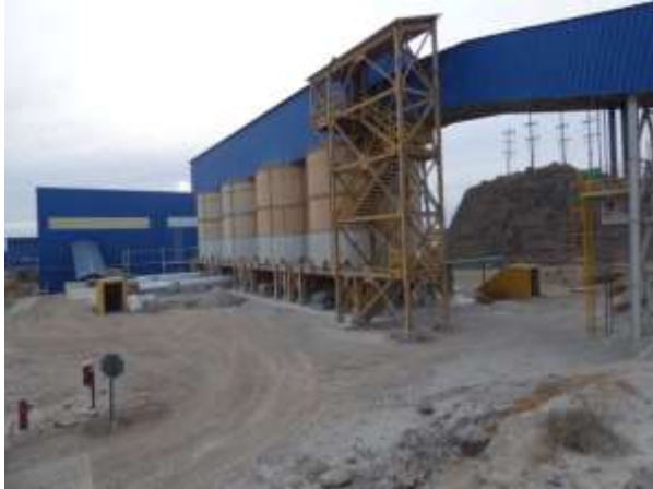
Fotografía 13: Detalle de los Silos en la Planta de Procesos
