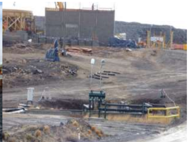
Fotografía 24: Detalle de la Planta de Relleno Hidráulico
