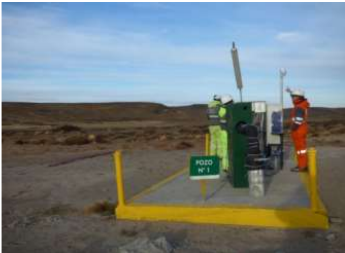
Fotografía 39: Detalle de pozo N°1 para abastecer al campamento
