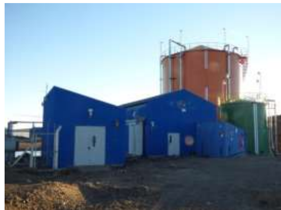
Fotografía 45: Tanque y planta de potabilización de agua de la UMSJ
